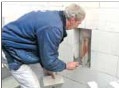
Ein Maurer der Firma Märkische Projektbau mauerte die Hülse professionell in das Fundament ein.
