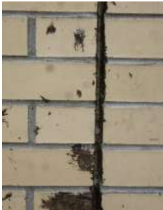
Abbildung 3: Fugenspalten am Hauptgebäude
