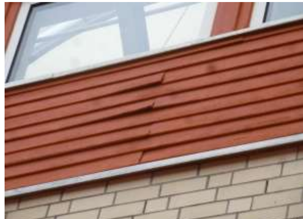
Abbildung 4: Abstehende Holzverkleidung der Turnhalle
