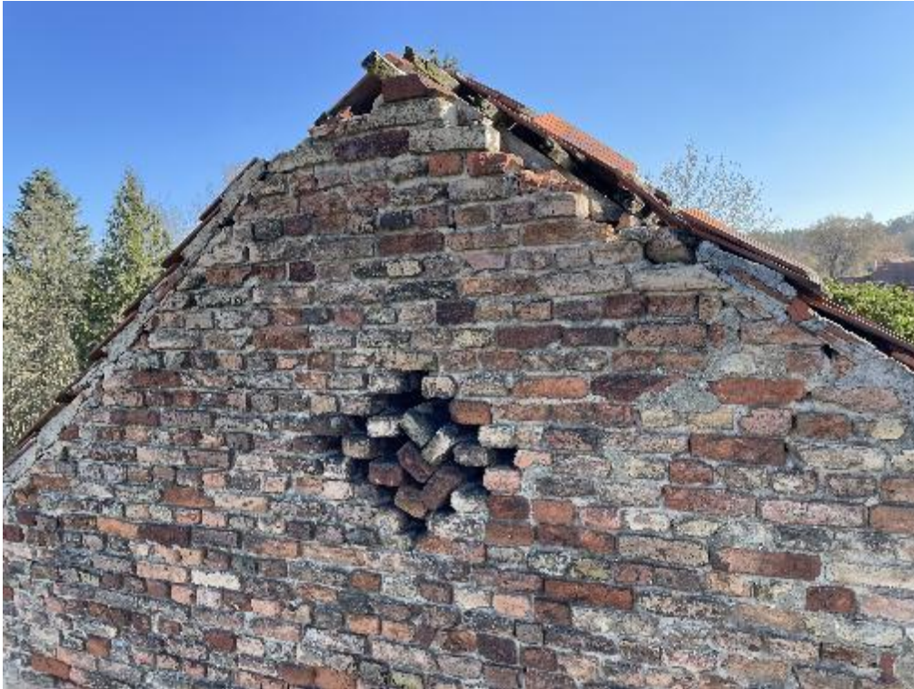
Abbildung 14: Dachgiebel von der Scheune mit Spalten und Höhlen im Mörtel als Quartierpotenzial, Bild vom 19.03.2024
