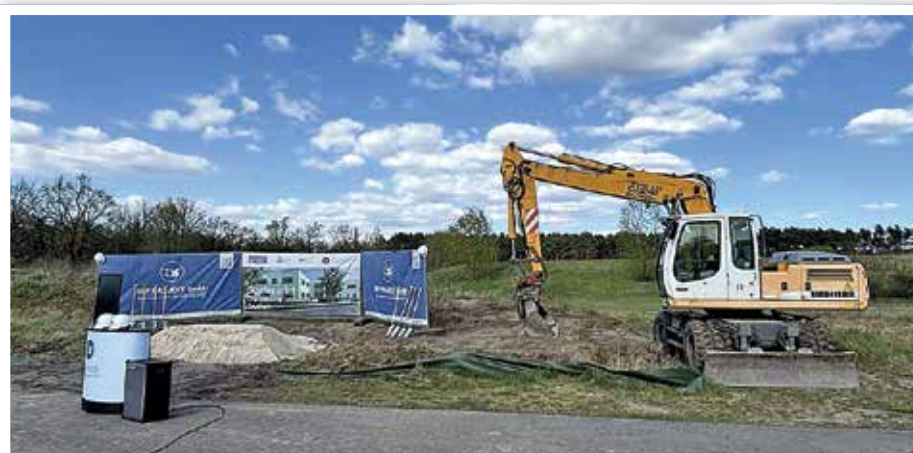
Alles perfekt für den Spatenstich für die evang. Grundschule im Zeuthener Winkel vorbereitet.
