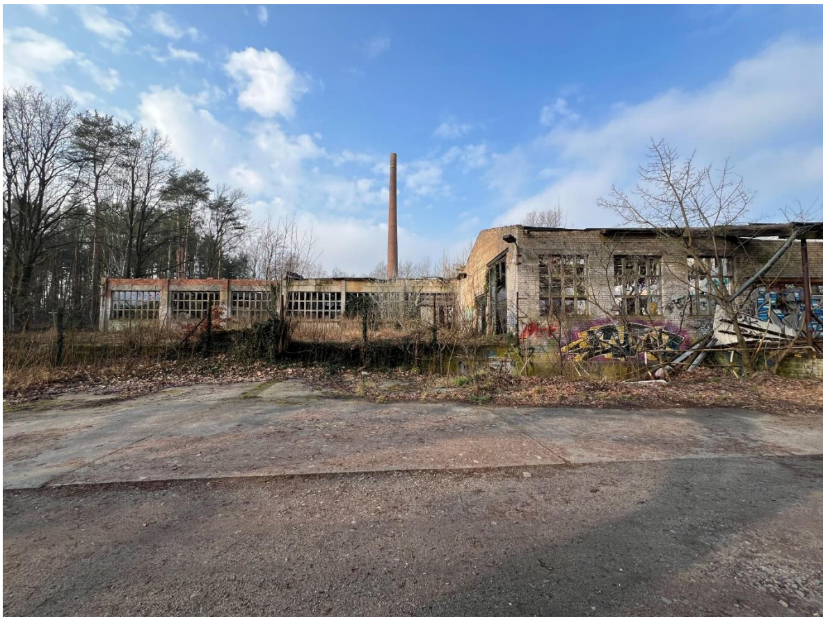
Abbildung 1: Aktueller Ist-Zustand auf den Flurstücken 25/1 und 29/1. Straßenseitige Fassadenansicht der Gewerberuinen von der Am Graben 33 aus.
