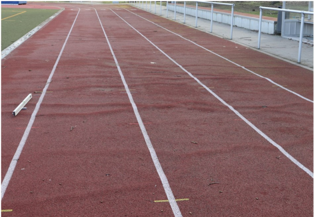
Bild 6: durch Wurzeleinwuchs verursachte Hebung der Laufbahn im gesamten Bereich der westlichen Laufbahngerade mit teilweisen Aufbrüchen
