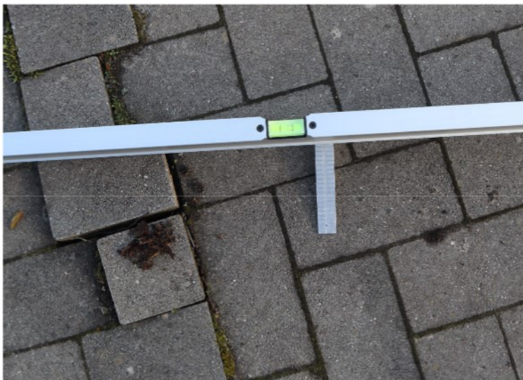
Bild 2: Hebungen durch Wurzeln im Bereich der Tribüne
