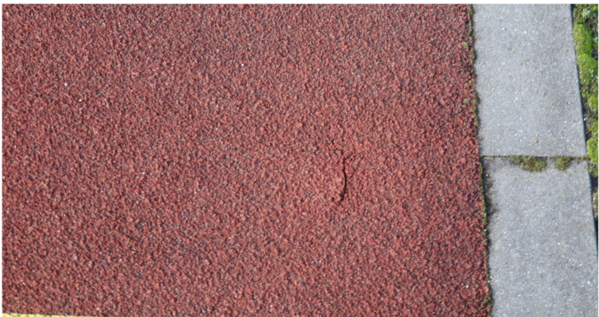
Bild 7: durch Wurzeleinwuchs verursachte Hebung der Laufbahn im Randbereich der östlichen Laufbahngerade mit teilweisen Aufbrüchen
