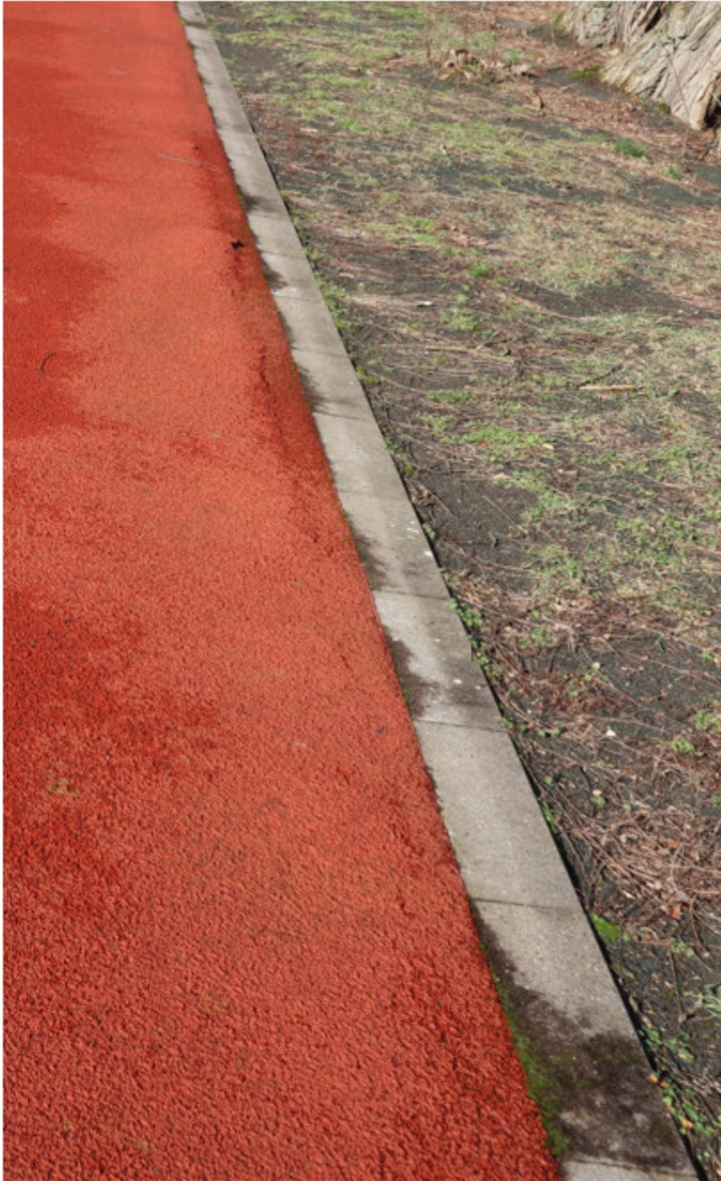
Bild 14: durch Wurzeleinwuchs verursachte Hebung der Laufbahn im Randbereich der östlichen Laufbahngerade mit teilweisen Aufbrüchen
