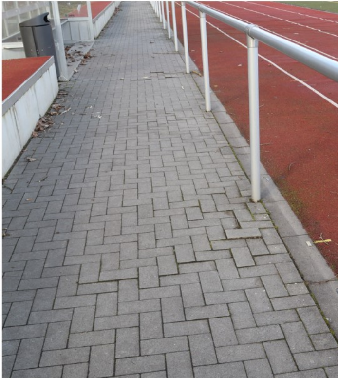
Bild 4: Hebungen durch Wurzeln im Bereich der Tribüne
