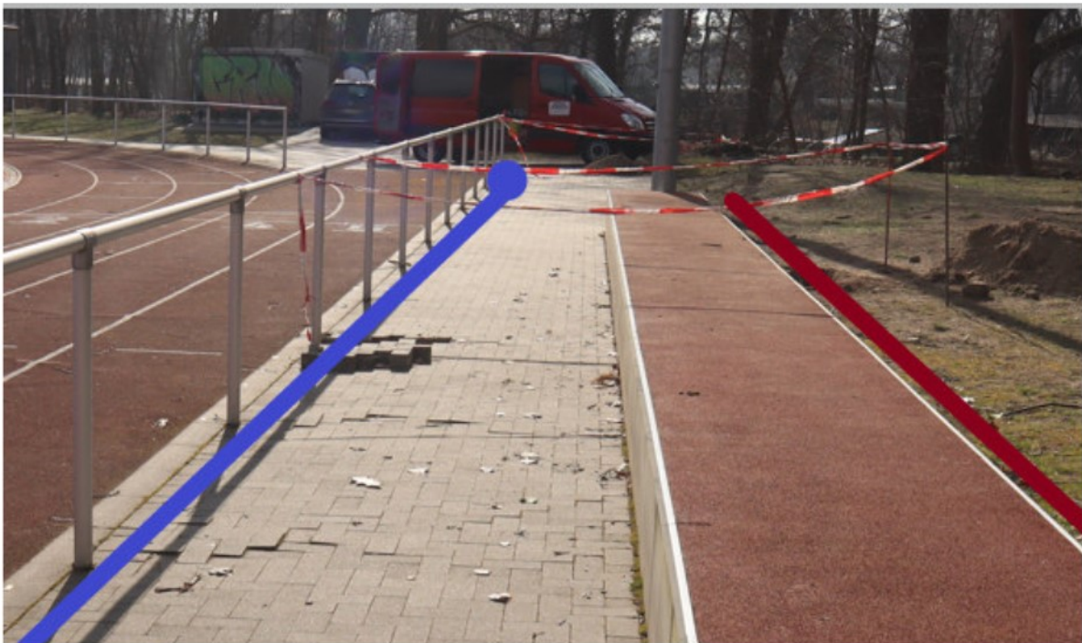
Bild 56: nach Hinweisen der Baufirma zusätzlich durchgeführte Sichtungen zum eingebauten Wurzelschutz, Einbau erfolgte an falscher Stelle, rot – geplant, blau - vorgefunden
