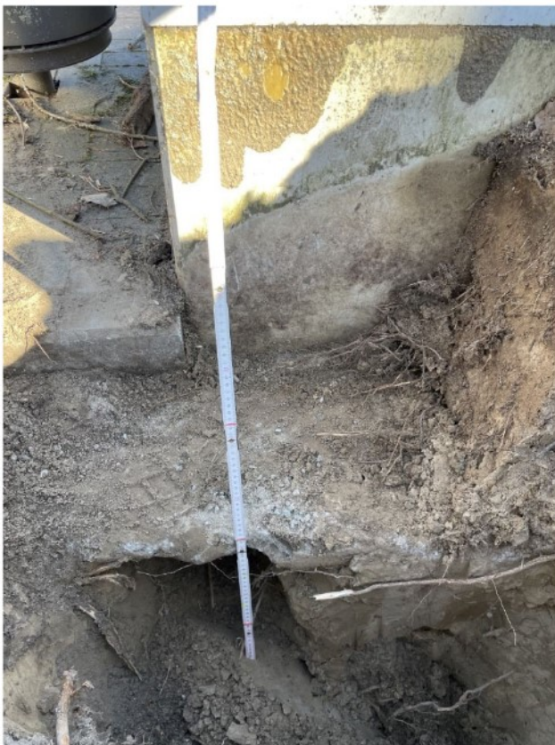
Bild 29: Suchgraben 5, ohne erkennbare Wurzelschutzfolie
