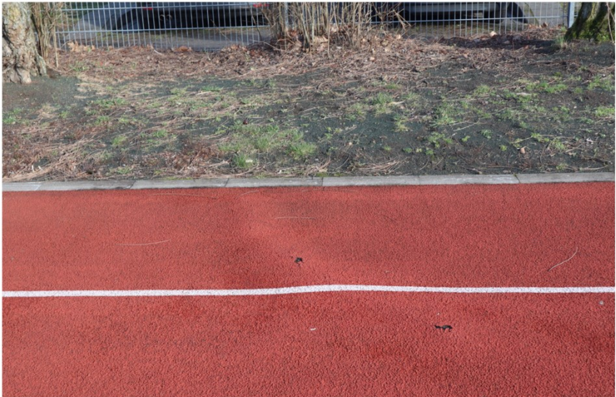
Bild 12: durch Wurzeleinwuchs verursachte Hebung der Laufbahn im Randbereich der östlichen Laufbahngerade mit teilweisen Aufbrüchen
