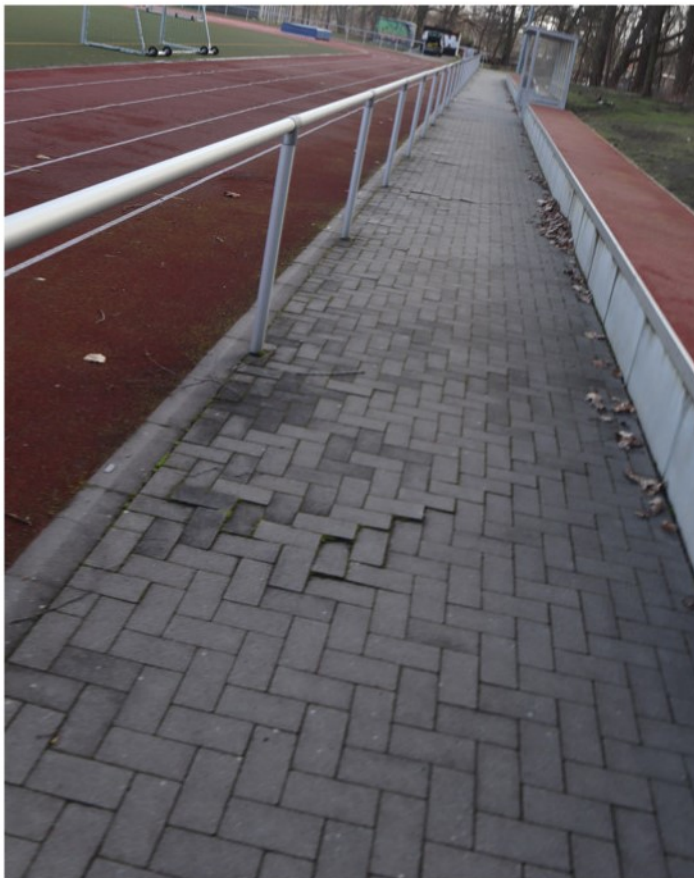
Bild 5: Hebungen durch Wurzeln im Bereich der Tribüne
