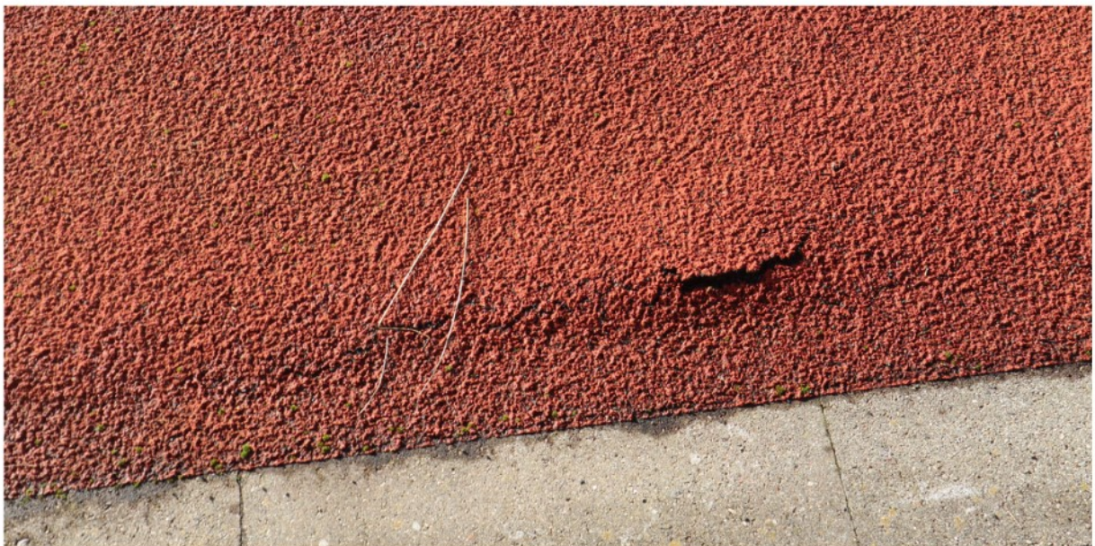
Bild 13: durch Wurzeleinwuchs verursachte Hebung der Laufbahn im Randbereich der östlichen Laufbahngerade mit teilweisen Aufbrüchen
