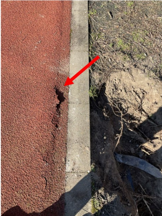
Bild 50: Suchgraben 14, aufgerissener Kunststoffbelag der Laufbahn
