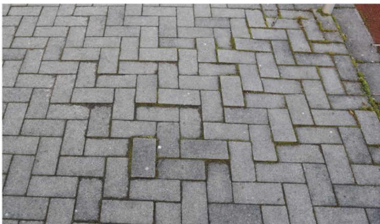
Bild 3: Hebungen durch Wurzeln im Bereich der Tribüne
