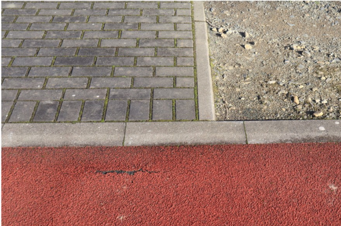
Bild 10: durch Wurzeleinwuchs verursachte Hebung der Laufbahn im Randbereich der östlichen Laufbahngerade mit teilweisen Aufbrüchen
