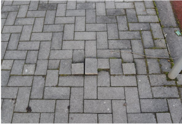
Bild 1: Hebungen durch Wurzeln im Bereich der Tribüne
