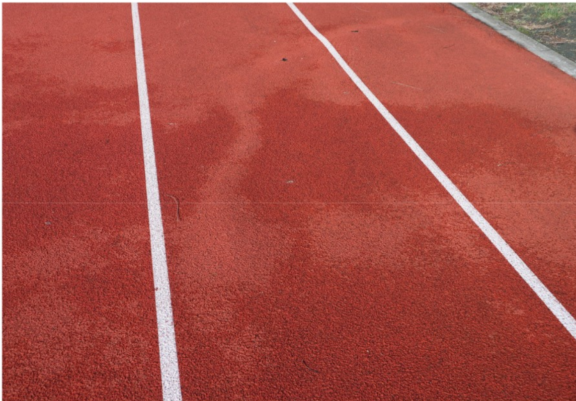
Bild 11: durch Wurzeleinwuchs verursachte Hebung der Laufbahn im Randbereich der östlichen Laufbahngerade mit teilweisen Aufbrüchen
