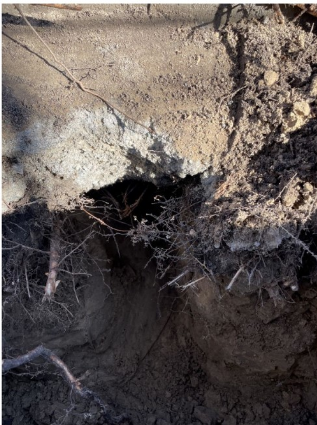
Bild 19: Suchgraben 1 (westliche Seite), lediglich Schwach- und Feinwurzeln vorgefunden und keine Wurzelschutzfolie erkennbar
