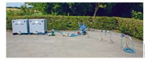
Besuchstages für eine Trinkwasser-Neuanlage mit 2000-Weil-Speicherbehälter, Pumpe und Zapfstellen
