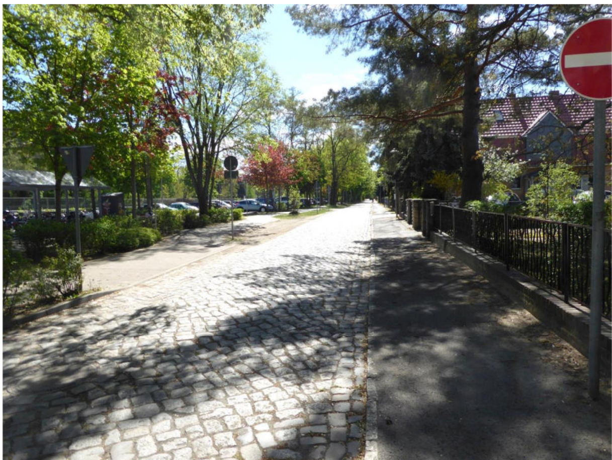
Abb. 15: Sehr schlechter Gehwegzustand in der Bahnstraße
