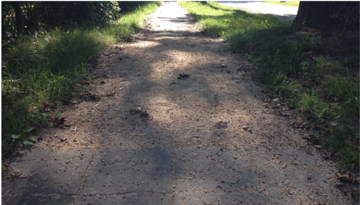
Abb. 29: Gehwegehöhungen bei Ausbesserungen mit Befestigungsmaterial ohne Bindemitte
