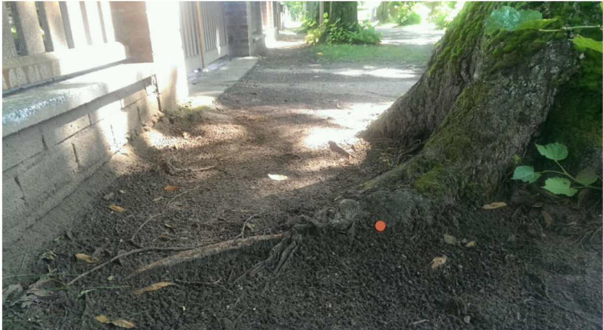
Abb. 25: Behinderungen auf unbefestigten Gehwegen durch Baumwurzeln
