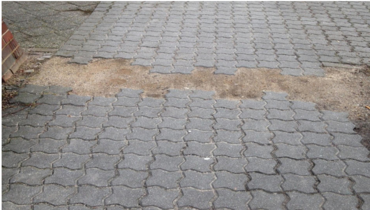
Abb. 28: Abrieb im Gehwegsbereich bei ausgebessertem Pflaster mit Befestigungsmaterial ohne Bindemittel
